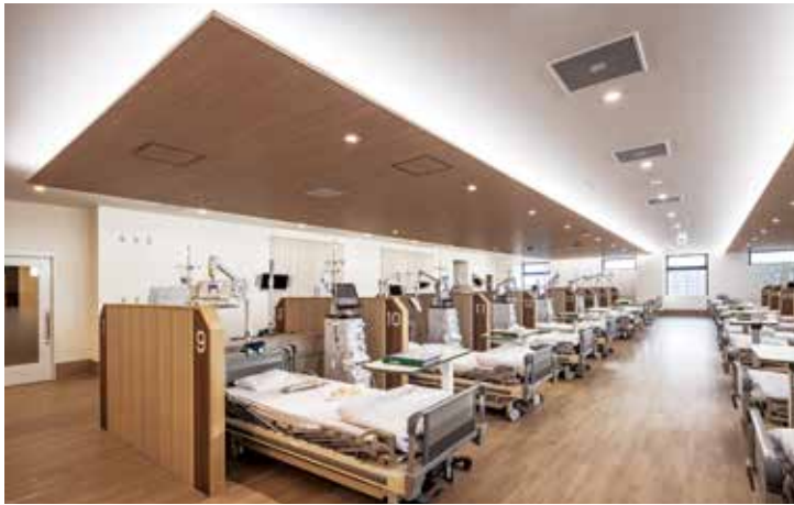
快適な空調システムの採用とプライバシーに配慮した透析室
